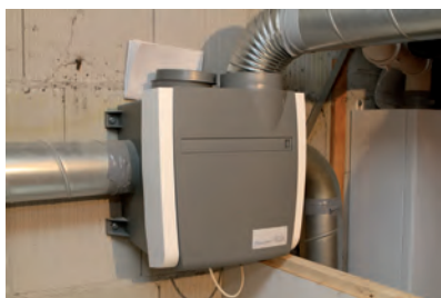
► Het mechanisch balansventilatiesysteem wordt gecombineerd met een Climarad radiator in de woonkamer.
